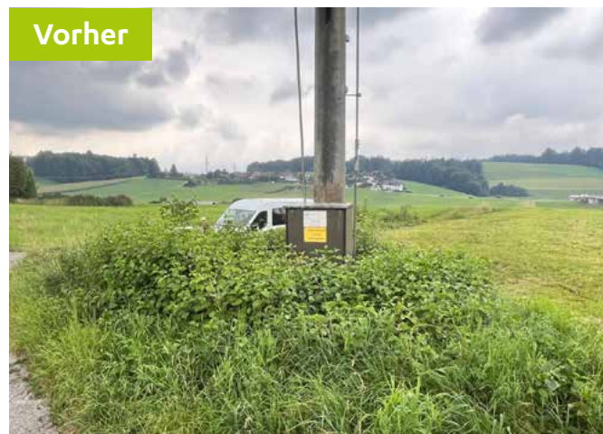
Salzburg AG – Trafostationen wieder frei!
